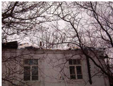
Abgebrannter Dachstuhl in Kök Schar
